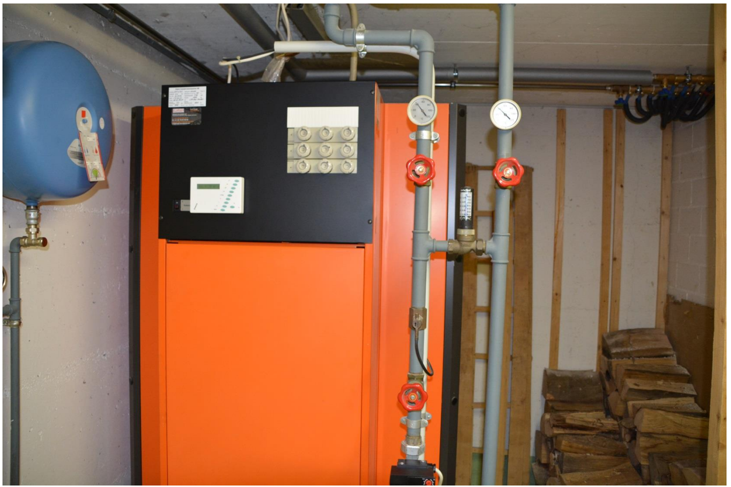
Frontansicht mit neuer Steuerung
